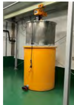
設備導入された脱ミネラル設備
