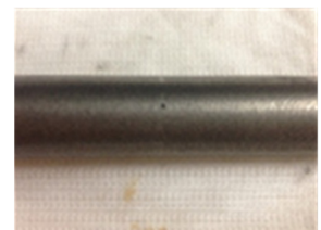
図2 casting 欠陥の例
