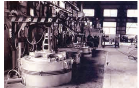
熱処理設備 (昭和55年頃)
